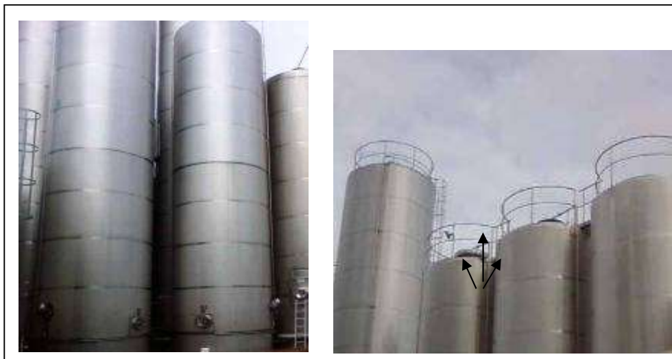
Abb. 10: Tanks für die Lagerung von Rohmilch oder Magermilch (links); Tankentlüftung, Domdeckel (rechts) Fotos: © LAVES
