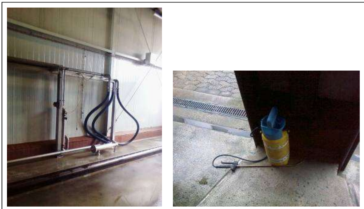
Abb. 11: Abtankvorrichtung in einer Abtankhalle (links);
