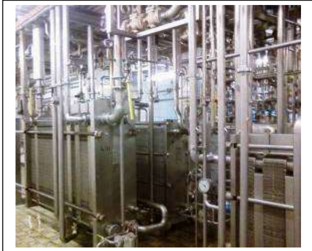
Abb. 13: Pasteurisierungsanlage Foto: © LAVES
